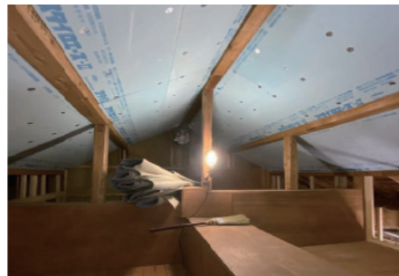
▲屋根断熱とすることで屋根裏のロフト空間を有効活用
